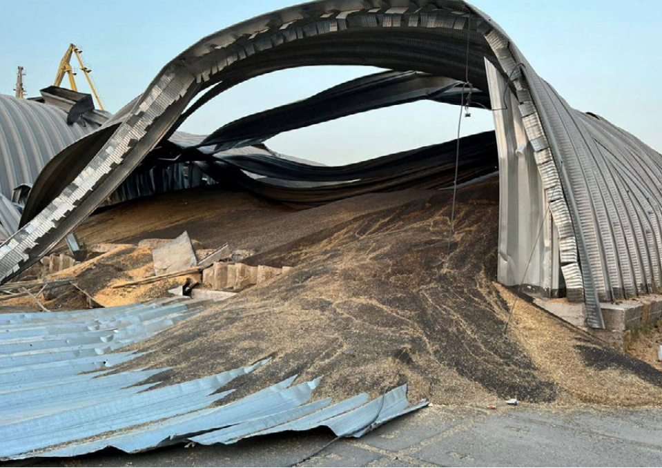
Ein Getreidelager, das durch einen russischen Drohnenangriff im Hafen von Reni im August 2023 beschädigt wurde. © Pressedienst der Einsatzleitung Süd der ukrainischen Streitkräfte/Handout via Reuters
