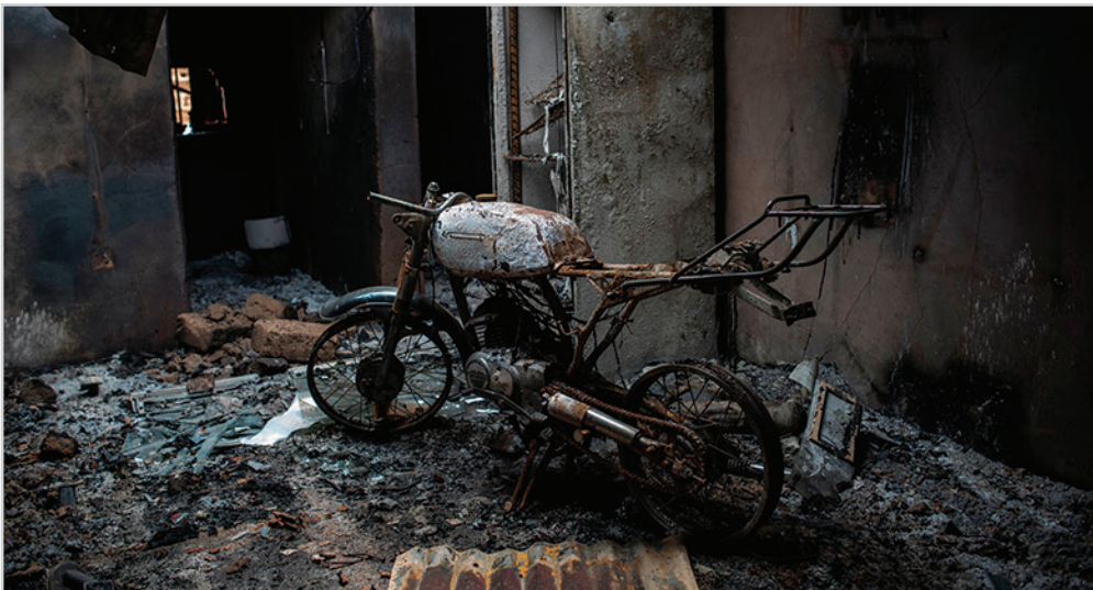
Cadre d'une moto calcinée dans une maison incendiée par des bergers Fulani dans le village de Ganaropp, dans la région de Barikin Ladi, près de Jos, le 27 juin 2018.
